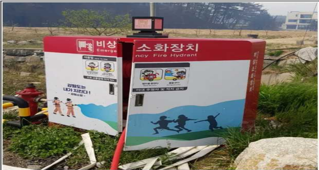
지난 11일 오후 강릉시 펜션단지의 진입로 옆에 설치된 마을 비상소화장치
